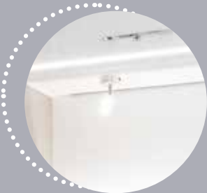
Eclairage à LEDS en partie cellule
